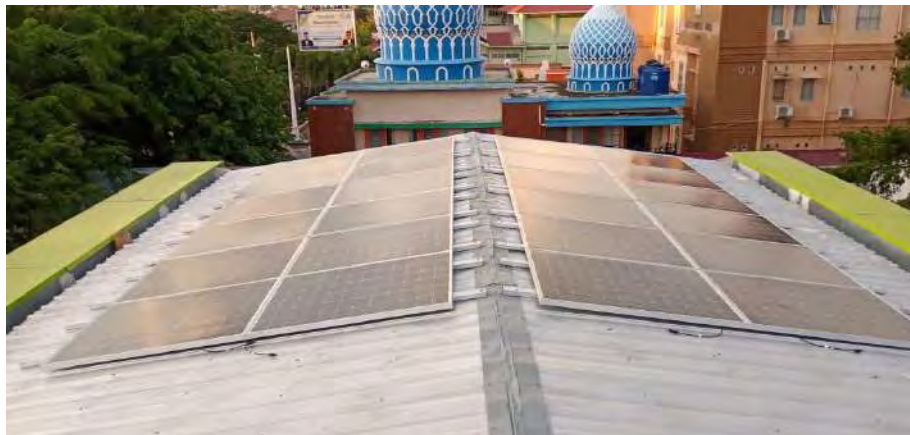
Gambar 4.7 Kondisi solar panel yang telah terpasang di atap gedung kantor pool kendaraan DLHK3 dengan total keseluruhan daya terpasang sebesar 6,6 kWp
